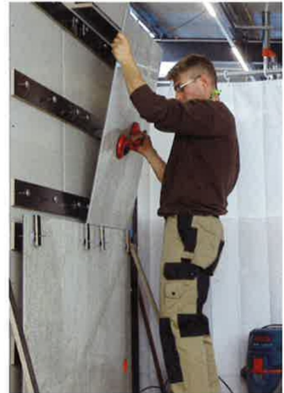
Leichtbau mit Naturstein: Für die schnelle Montage von BlendStone-Hybrid-Natursteinplatten mittels »ReVisionSys«-Magnethaltesystem braucht es eine Arbeitskraft und nur wenige unterstützende Hilfsmittel.
